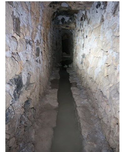
Galerie de drainage de la source de la Petite Saussaie (Cerema)
