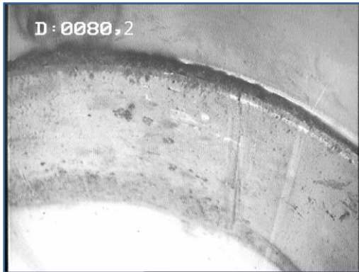
Défaut d'étanchéité d'un raccord
