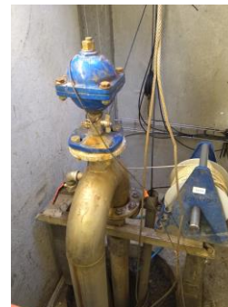
Contrôle d'une sonde auto.
